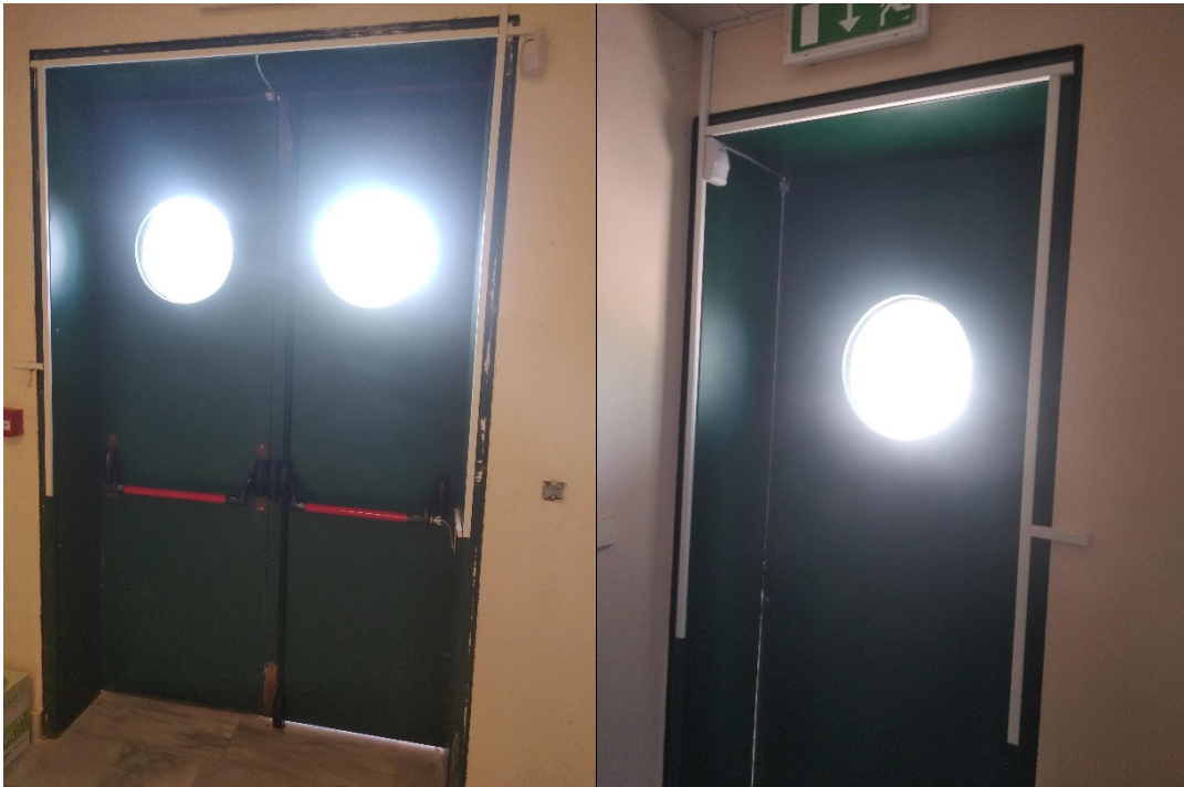
Φωτογραφία 2: Υπάρχουσες μεταλλικές θύρες προς αντικατάσταση.
